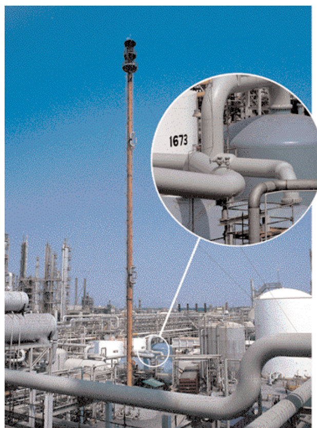
Instalação de campo do DigitalFlow GF868 em um sistema de flare típico. O detalhe mostra os transdutores instalados no coletor da chama, que leva à chaminé.
